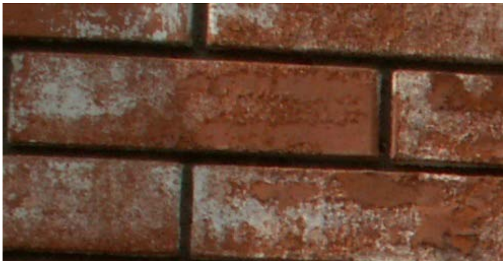
Фото 1. Результат солевой коррозии на фасаде: ровные розовые участки – неразрушенная поверхность керамического кирпича, темные полосы – отшелушивание лицевого слоя, белесые пятна - высолы.
